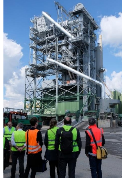
Nachgerüstete Asphaltmischanlage von PORR: Neue Bauteile sind am hellen Glanz erkennbar
